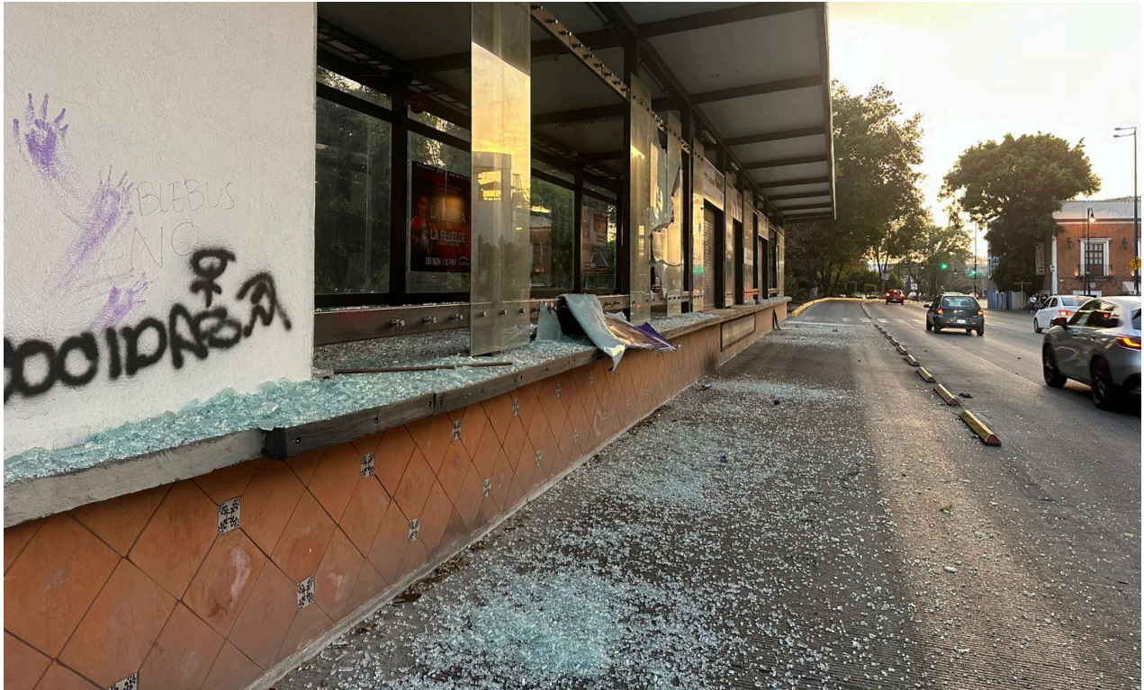
Las terminales del sistema RUTA ubicadas sobre el vulebar 5 de Mayo fueron vandalizadas. Foto: Gobierno de Puebla
